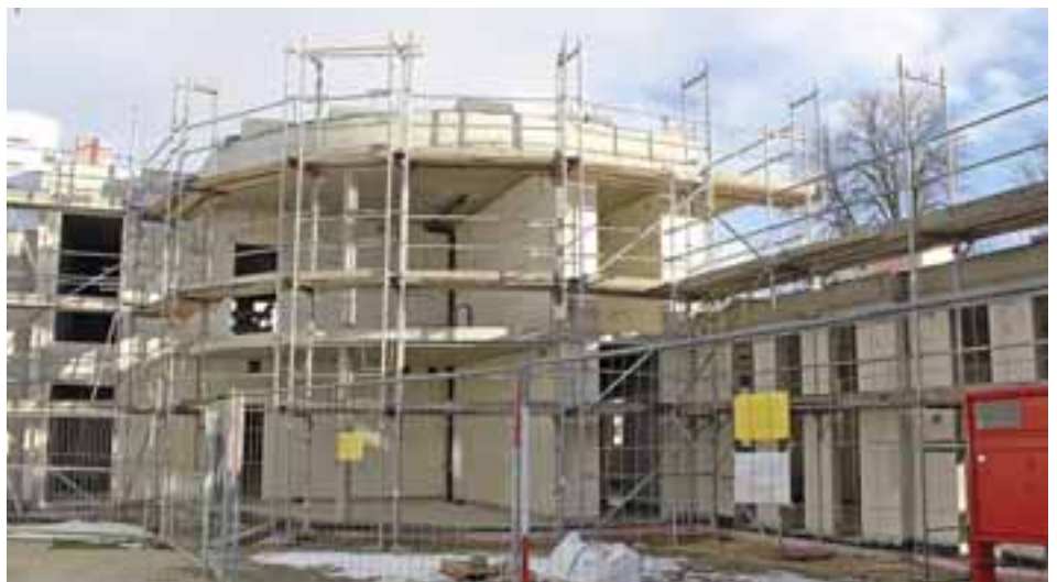
Im Rohbau: Ein Korridor verbindet das neue Halbrund mit dem der bestehenden Wache.
